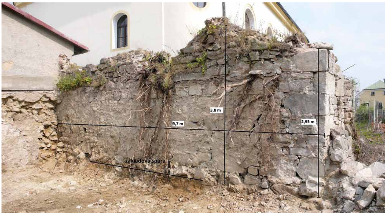
Obr. 6. Tisová, ohradní zeď areálu kostela. Pohled od jihozápadu v místě po demolici polozapuštěného objektu s valenou klenbou. Konstrukce B – západní líc. (Foto s grafickými úpravami M. Waldmannová, 2012)
