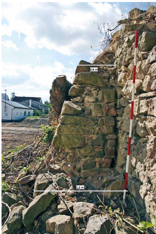
Obr. 10. Tisová, ohradní zdi areálu kostela sv. Mikuláše. Fragment opěrného pilíře (konstrukce C). Pohled od severu. (Foto L. Foster, 2012. Grafické úpravy M. Waldmannová, 2013)
